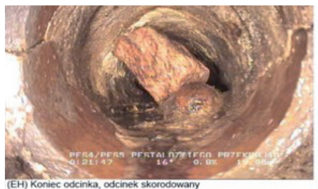
(EH) Koniec odcinka, odcinek skorodowany
